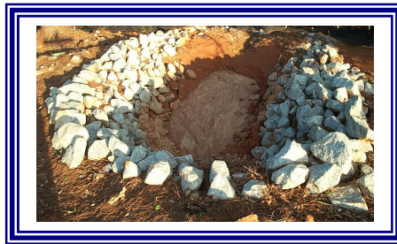
Rock Sediment Dike
