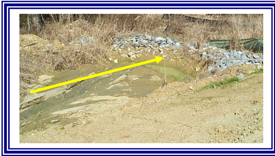
Rock Sediment Dike
